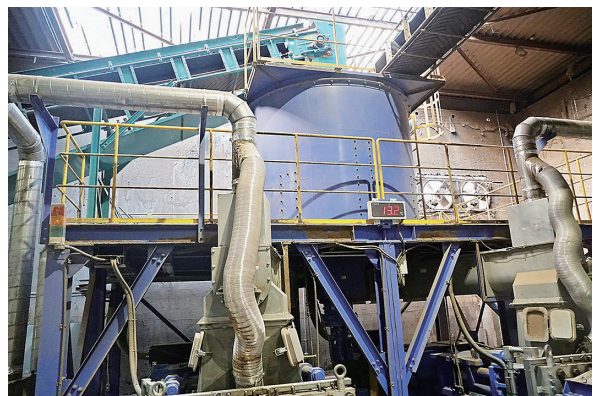
<混合機から送られる原料を熱で凝縮成形させる固形設備>
