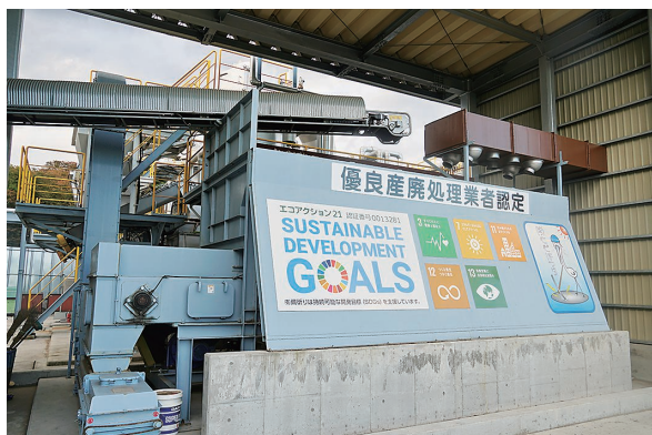
自社製造のRPF固形燃料を使用するバイオマスボイラー設備
