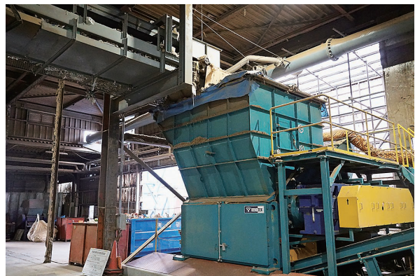
<木くず、廃プラスチック類、繊維くず等を混合する大型混合機>
